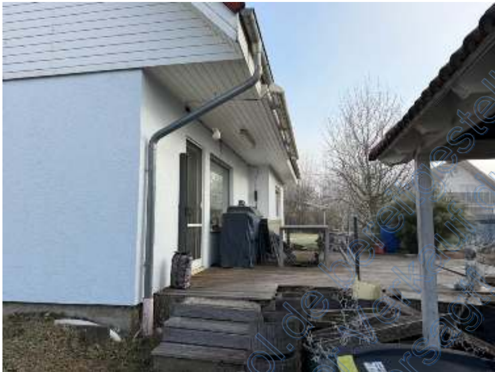
Terrasse von Westen, schadhafte Treppe
