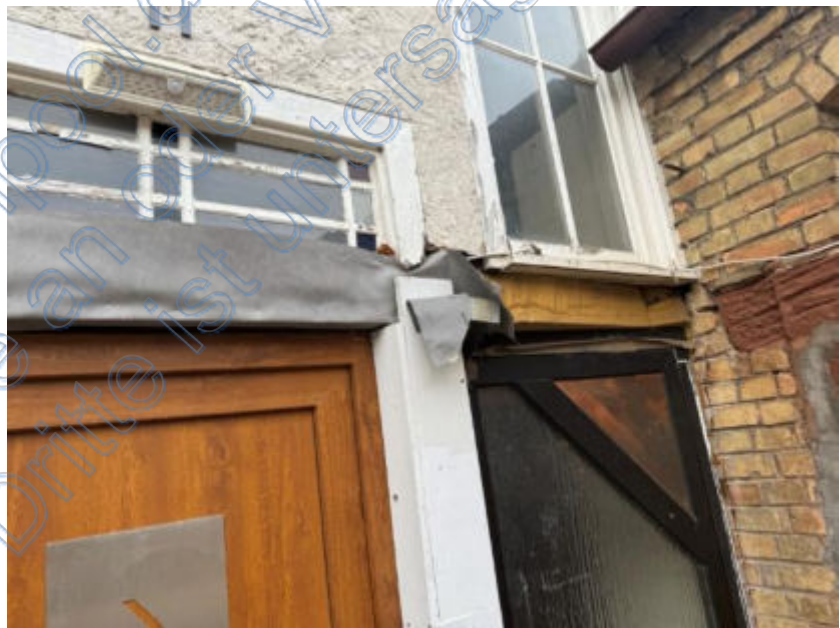
Abb. 7: Foto des SV; z.T. unvollständige Fensterlaibungen und schadhafte Anschlüsse
