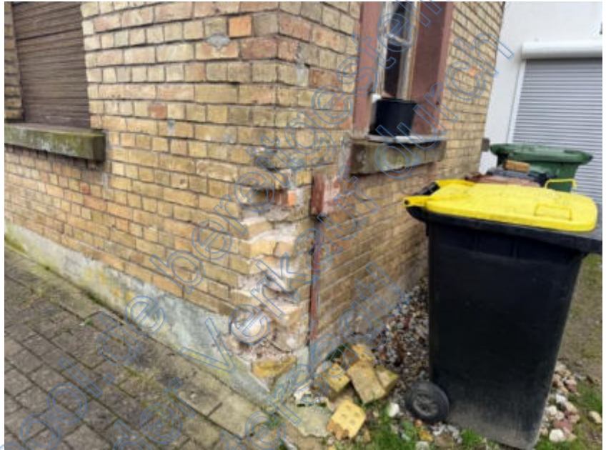
Abb. 10: Foto des SV; z.T. Fassade schadhaft (Mauerwerksausbrücke)
