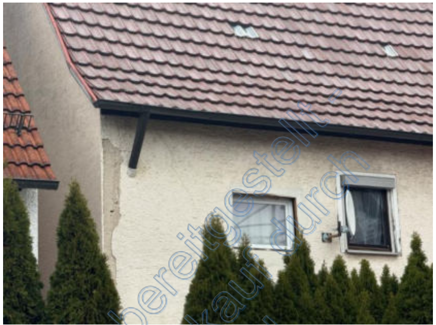
Abb. 8: Foto des SV; z.T. Fassade schadhaft (Putzabplatzungen)
