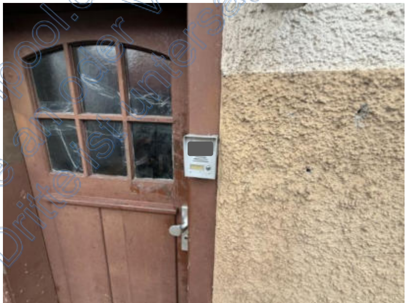
Abb. 9: Foto des SV; z.T. Türen schadhaft (Glasbruch)
