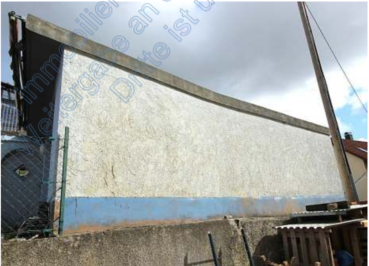
Südwestseite der Garage mit Verschmutzungen an der Fassade und Schäden im Sockelbereich
