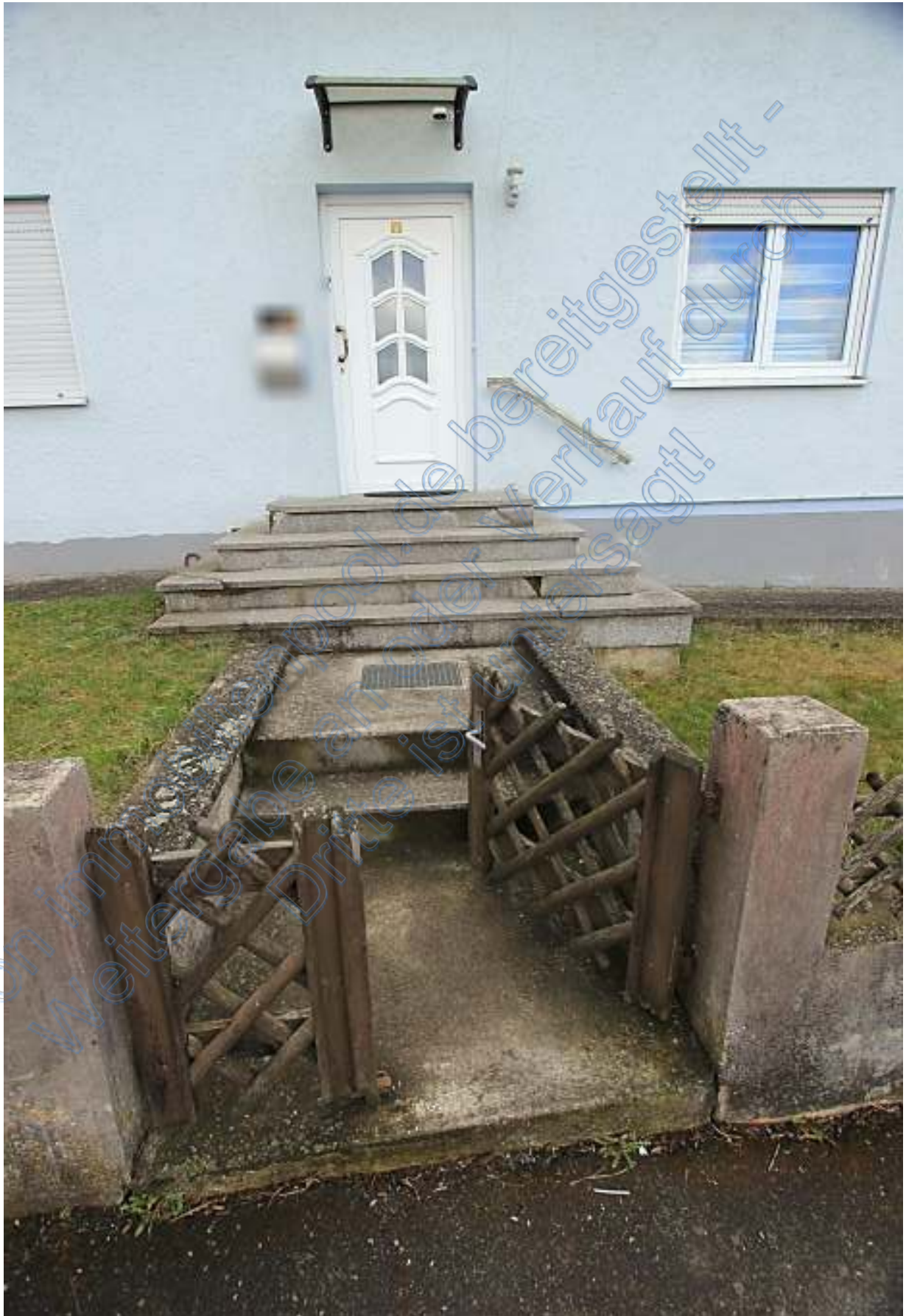
Hauszugang mit Eingangstor, Eingangstreppe und neuer Haustür
