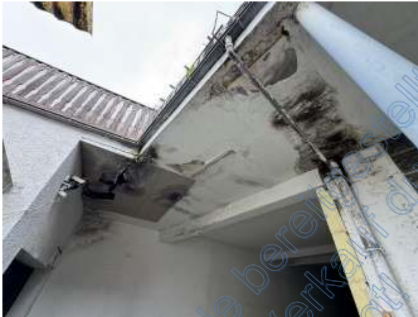
Bild 7: Beschädigungen im Deckenbereich des Innenhofes
