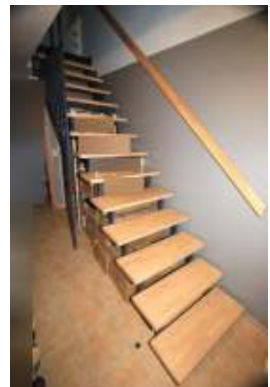
Treppe, fehlendes Geländer
