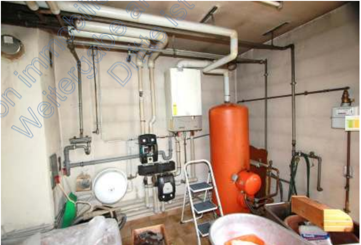
Heizungsraum im Südosten des Gebäudes, rechts Gasanschluss
