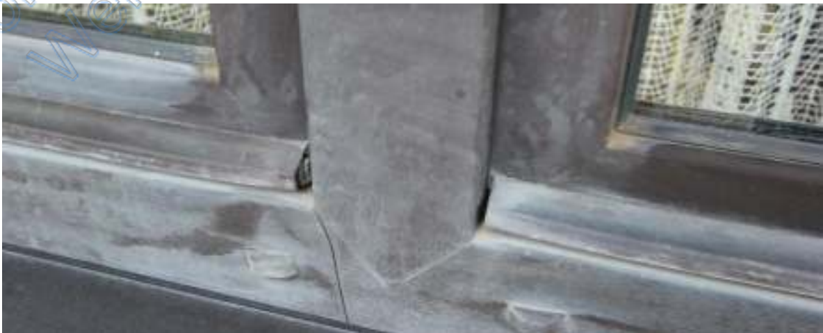
Verblasste Rahmen der Kunststofffenster außen
