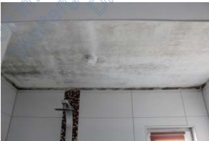
Foto 14: Schimmelschaden an der Badezimmerdecke im OG des Wohnhauses
