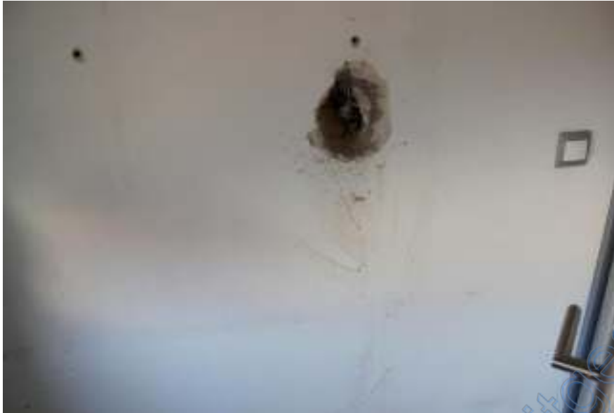
Foto 12: schadhafte Wand im Zimmer im OG des Wohnhauses
