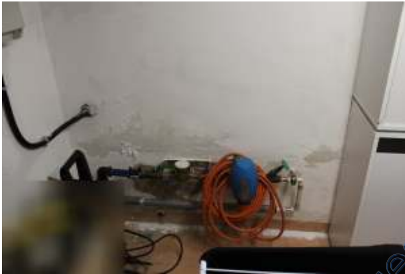
Foto 5: Blick auf die Außenwand im Kellerraum mit einem Feuchteschaden
