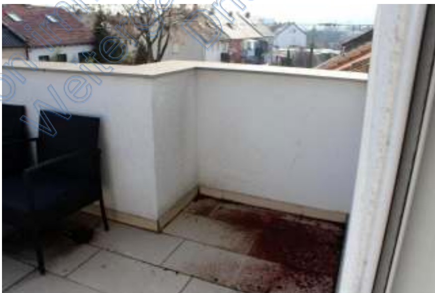
Foto 20: schadhafter Fliesenbelag auf der Dachterrasse
