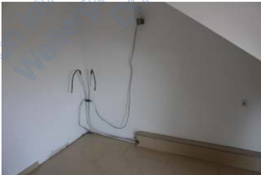
Foto 17: Anschluss für eine Dusche im DG des Wohnhauses
