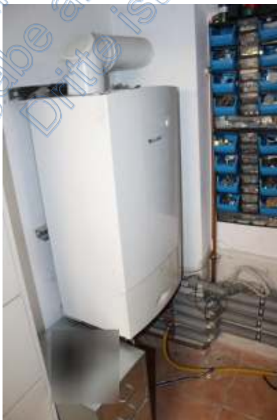
Foto 7: Blick auf die Gastherme im UG des Wohnhauses
