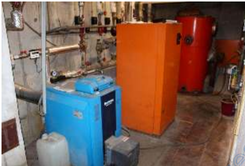
Foto 11: Heizraum im UG des Wohn- und Geschäftshauses
