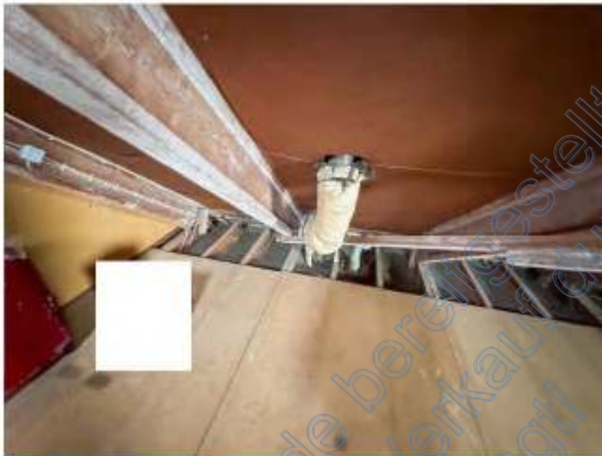
Bild 23: tlw. fehlende Dämmung
