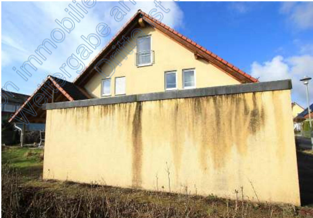
Ostseite der Doppelgarage mit Wasserschäden, dahinter Ostgiebelseite Haushälfte ATP Nr. 1
