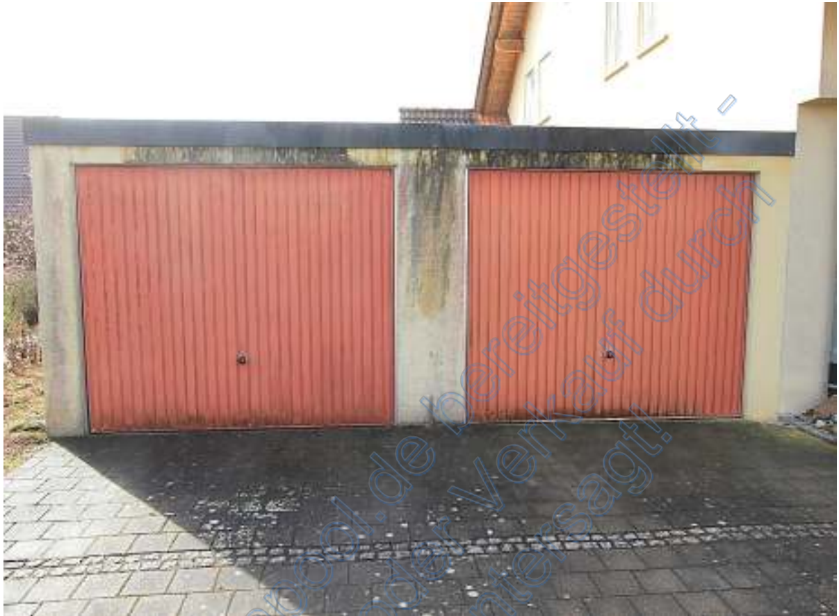
Nordseite der Doppelgarage , Wasserschäden unter dem Dach
