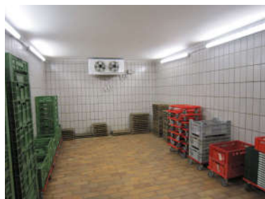
Kühlraum im Untergeschoss
