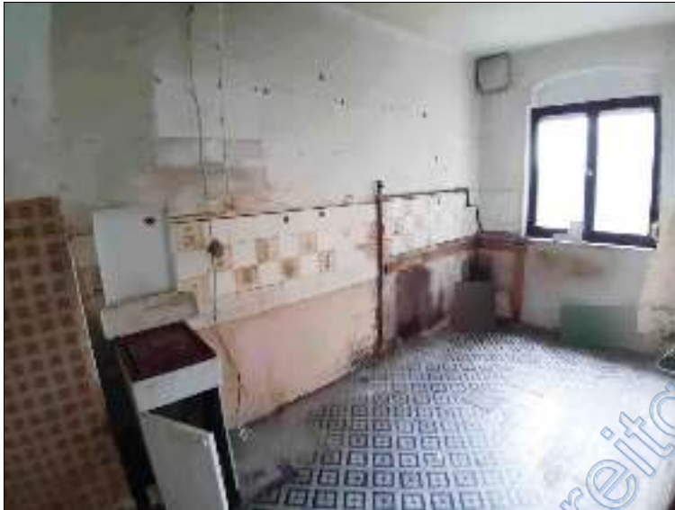
Erdgeschoß Küche, Bodenbelag defekt
