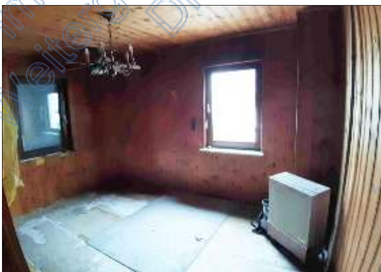
Erdgeschoß Zimmer, Bodenbelag fehlt
