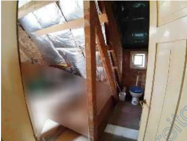
Dachgeschoß Zimmer und WC, Zwischenwand entfernt, Bodenbelag fehlt
