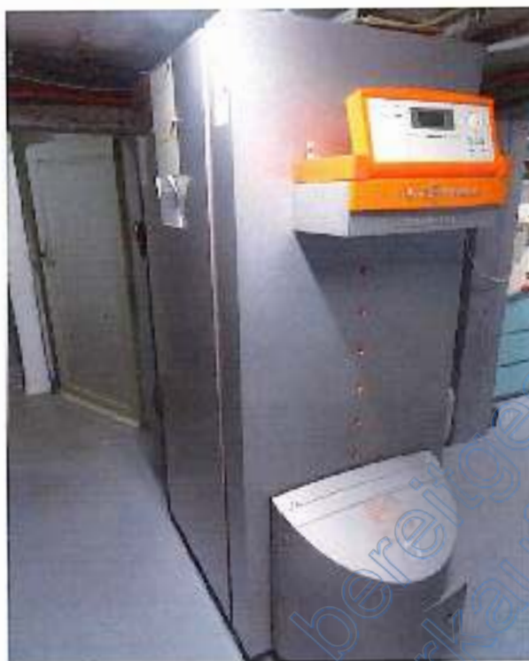
Foto 8: Heizanlage im KG
