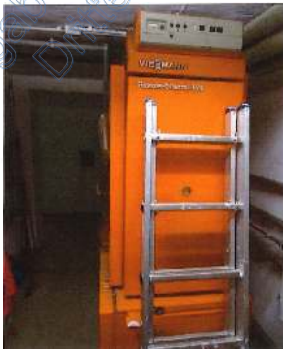
Foto 7: Heizanlage im KG
