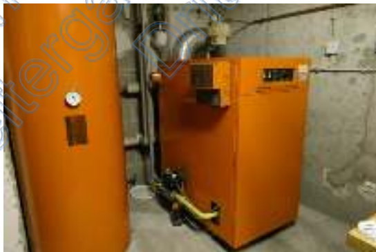
Abb. 16: Blick in den Fahrradabstellraum und auf die Heizungsanlage
