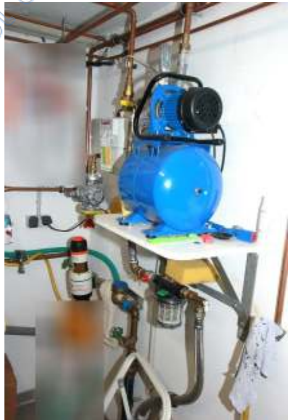
Wasserpumpe für Zisterne
