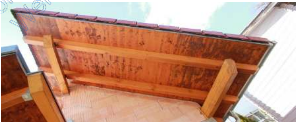
Untersicht Dach des Geräteschuppens mit Anstrichmängeln
