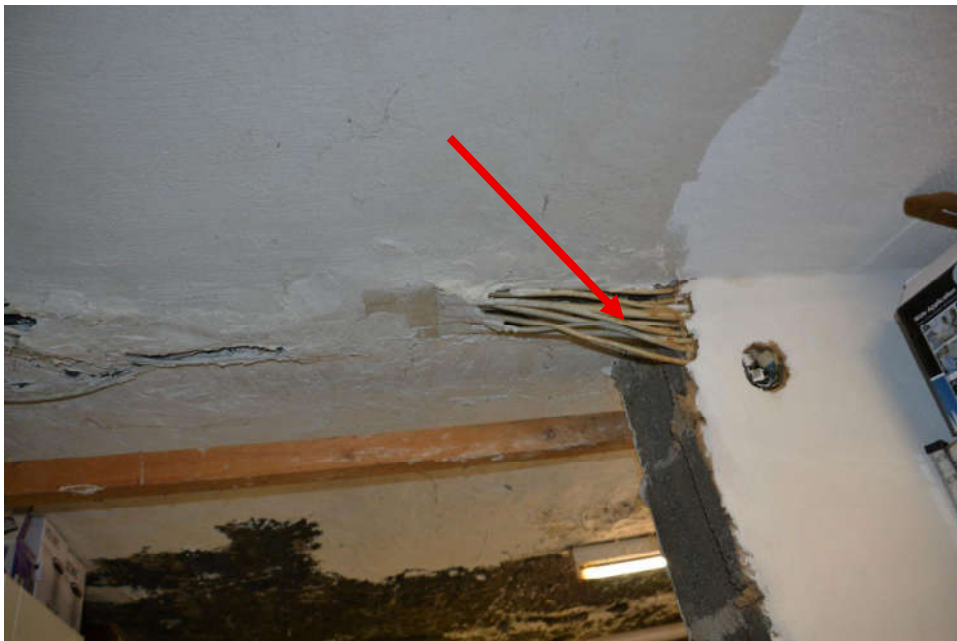
Bild 12: Untergeschoss mangelhafte Abschottung (Pfeil)
