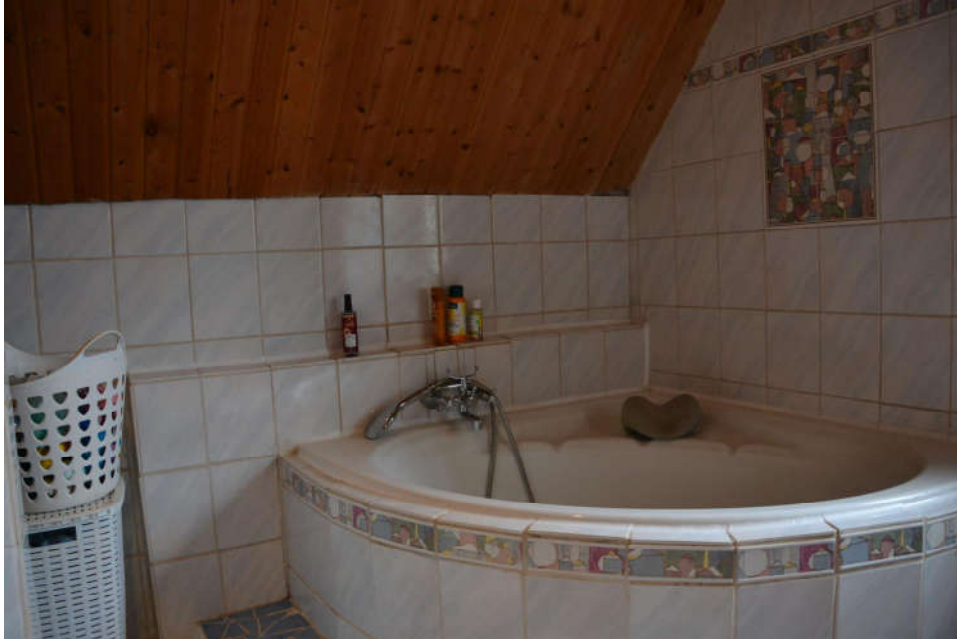
Bild 23: Dachgeschoss nicht fachhandwerkliche Ausführung der Entwässerung, Badewannenentwässerung nicht funktionsfähig (tropft in die Küche)
