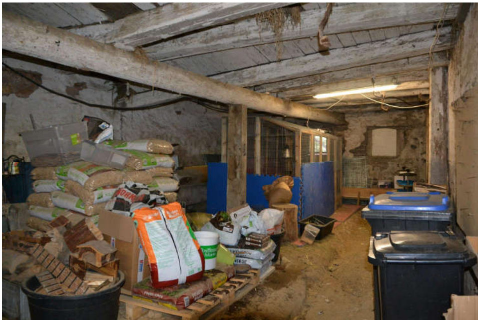
Bild 16: Erdgeschoss Nebengebäude, Statik einsturzgefährdet
