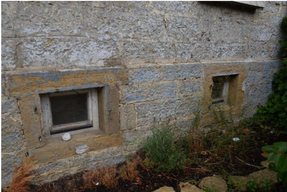
Bild 7: mangelhafte Abdichtungsarbeiten, kein Spritzschutz
