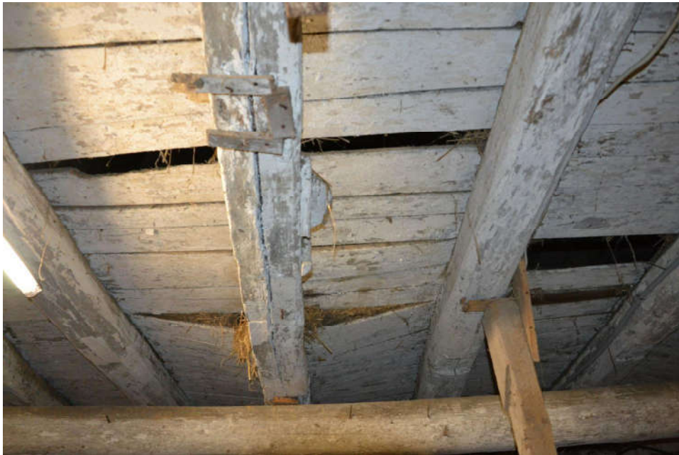
Bild 15: Erdgeschoss Nebengebäude, Standsicherheit gefährdet
