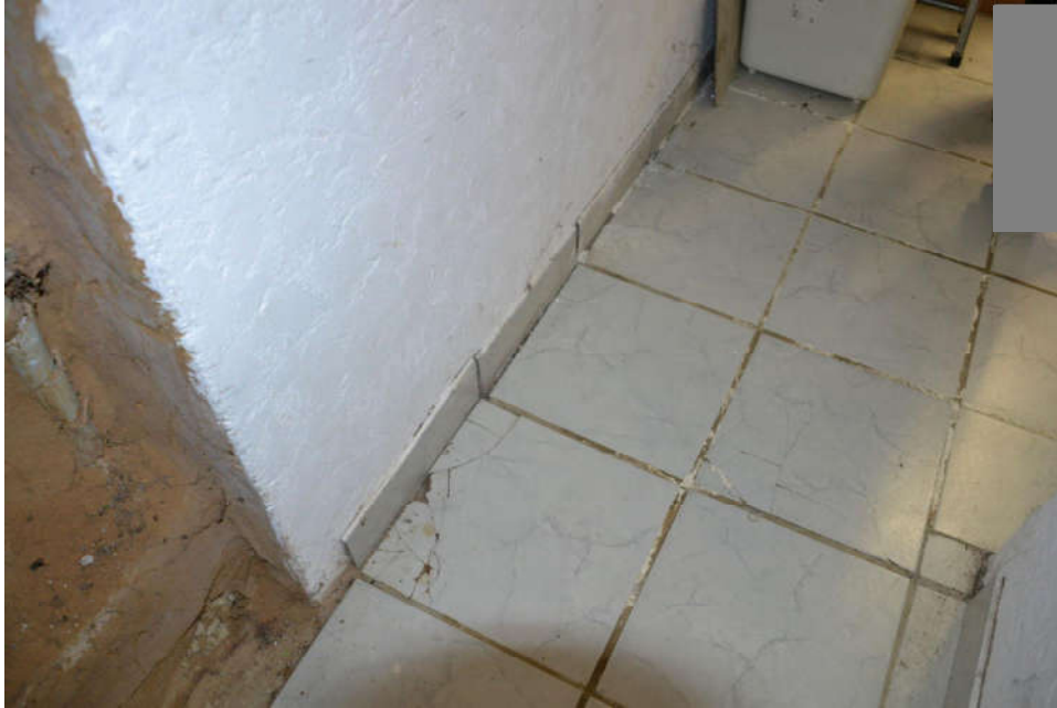
Bild 9: Untergeschoss Risse Bodenbelag
