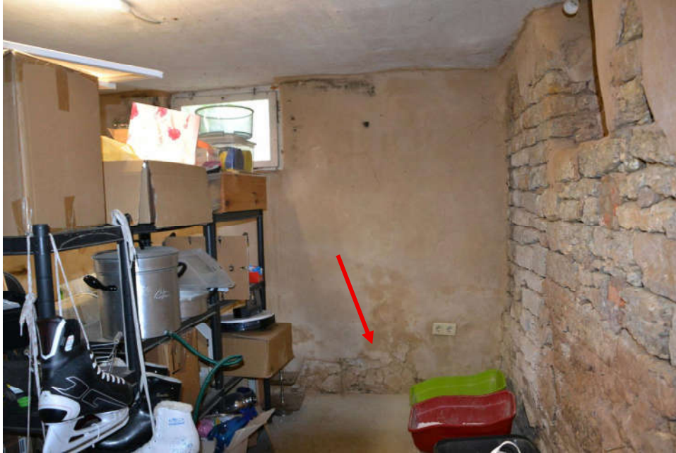
Bild 11: Untergeschoss Ausblühungen (Pfeil)
