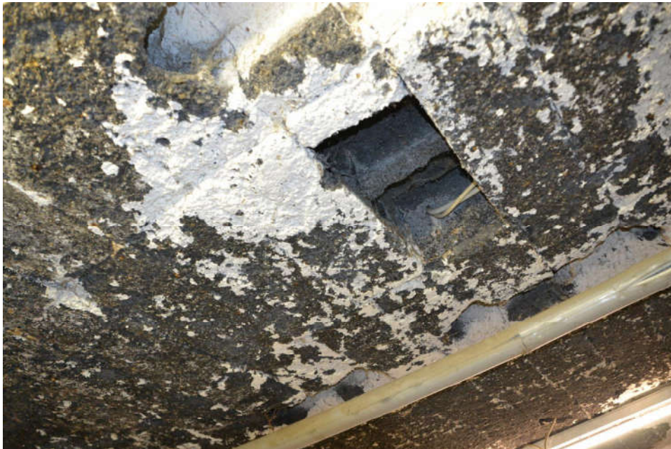
Bild 10: Untergeschoss Decke, rieselt Material ab
