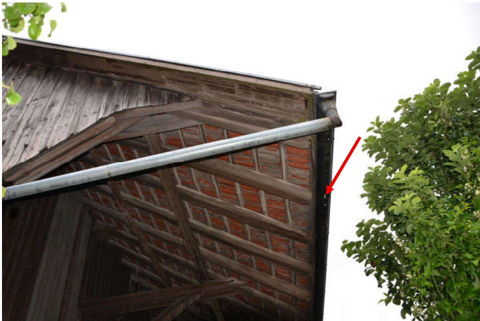
Bild 20: Nebengebäude, defektes Dachentwässerungssystem
