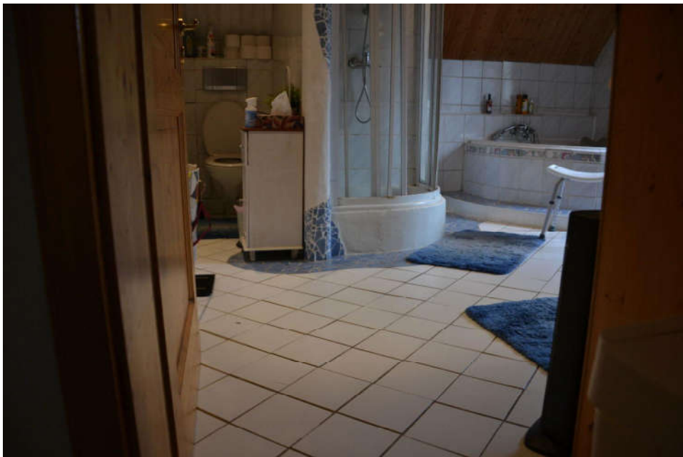
Bild 24: Dachgeschoss nicht fachhandwerkliche Ausführung der Verlegearbeiten
