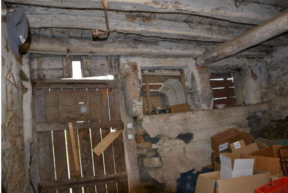
Bild 17: Erdgeschoss Nebengebäude, Statik einsturzgefährdet
