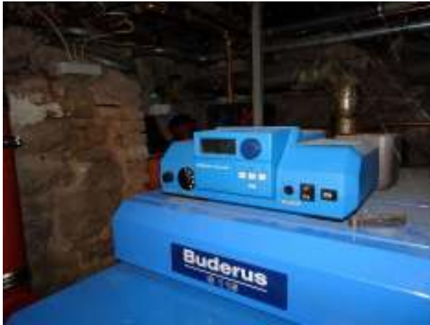
Heizungsanlage im Untergeschoss
