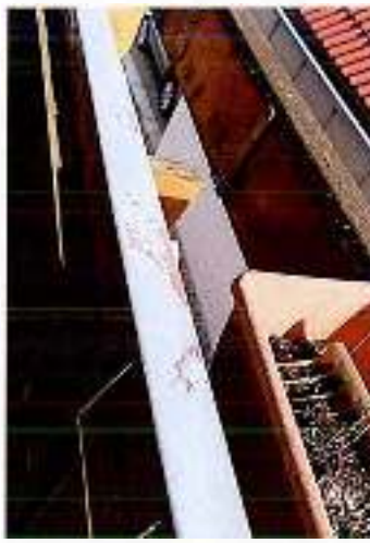
(65) Balkon Stahlträger Geländer korrodiert
