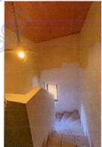
(78) Malerarbeiten sind zum Teil erforderlich
