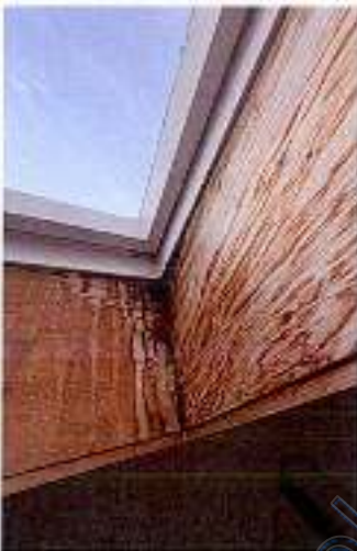
(76) Wasserspuren an der Leibung des Dachflächenfenster im Bad DG
