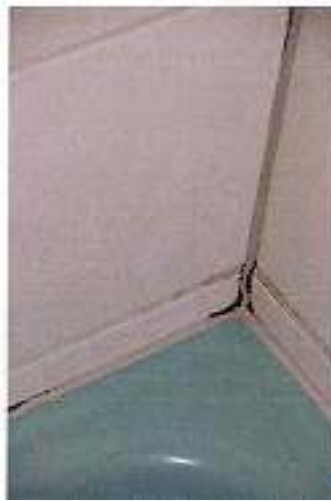
(74) Dusche DG mit Schimmel
