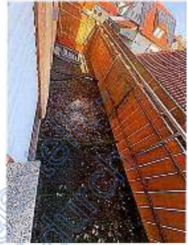
(66) Bodenmatte geklebt auf Fliesenbelag löst sich
