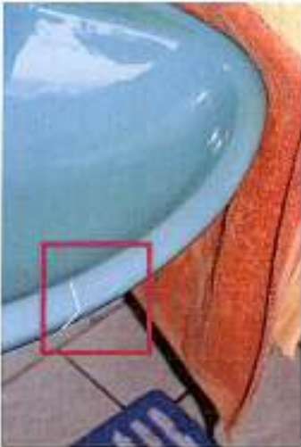
(73) Waschbecken im EG mit Riss; Riss wurde markiert
