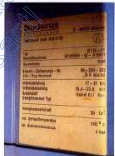
(24) Ölheizung Buderus Wärmeleistung 17-21 KW
