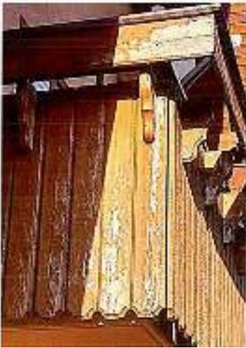
(64) Holzwerk Balkon muss gestrichen werden
