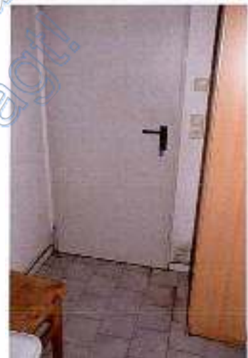
(69) Feuchtigkeitsschaden und Schimmel Aus-
