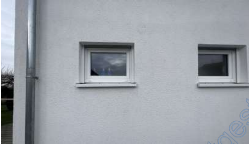
Ansicht Eingangsfassade, Fenster/ Fensterbrett links schief
