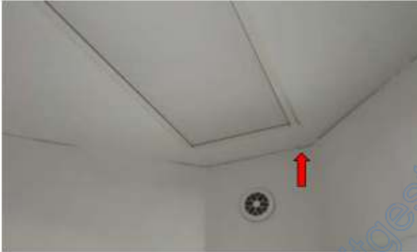
Decke im Flur OG, Zugang zum Dachboden - Umlaufende Risse zwischen Wand und Decke
