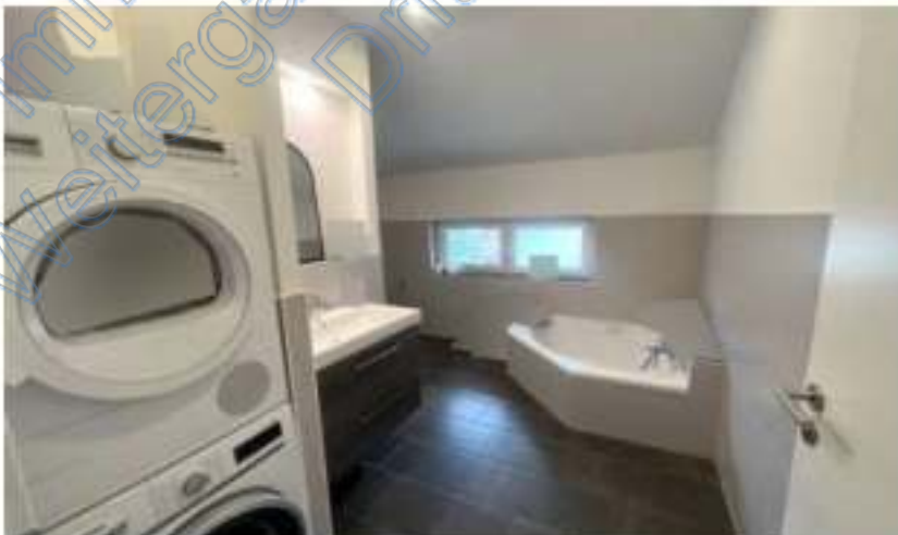
Badezimmer OG - Fliesen teilweise hohl am Boden
