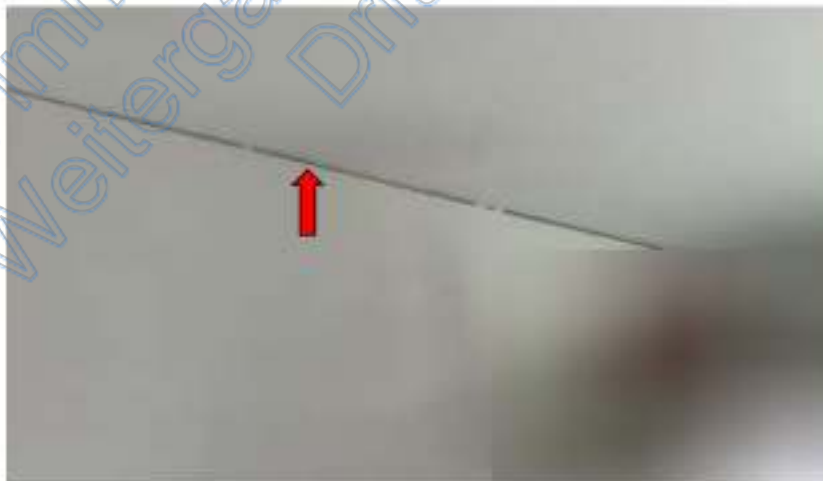
Detail Decke / Wand im Kinderzimmer - Riss zwischen Wand und Decke
