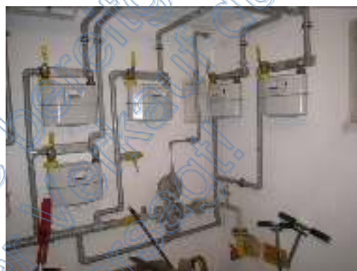
Innenansicht Untergeschoss Technikraum
