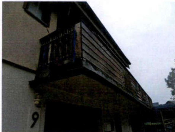
Feuchtigkeitsschäden Balkon zur Straße
