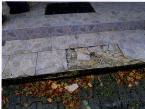
defekte Fliesen Eingangspodest
