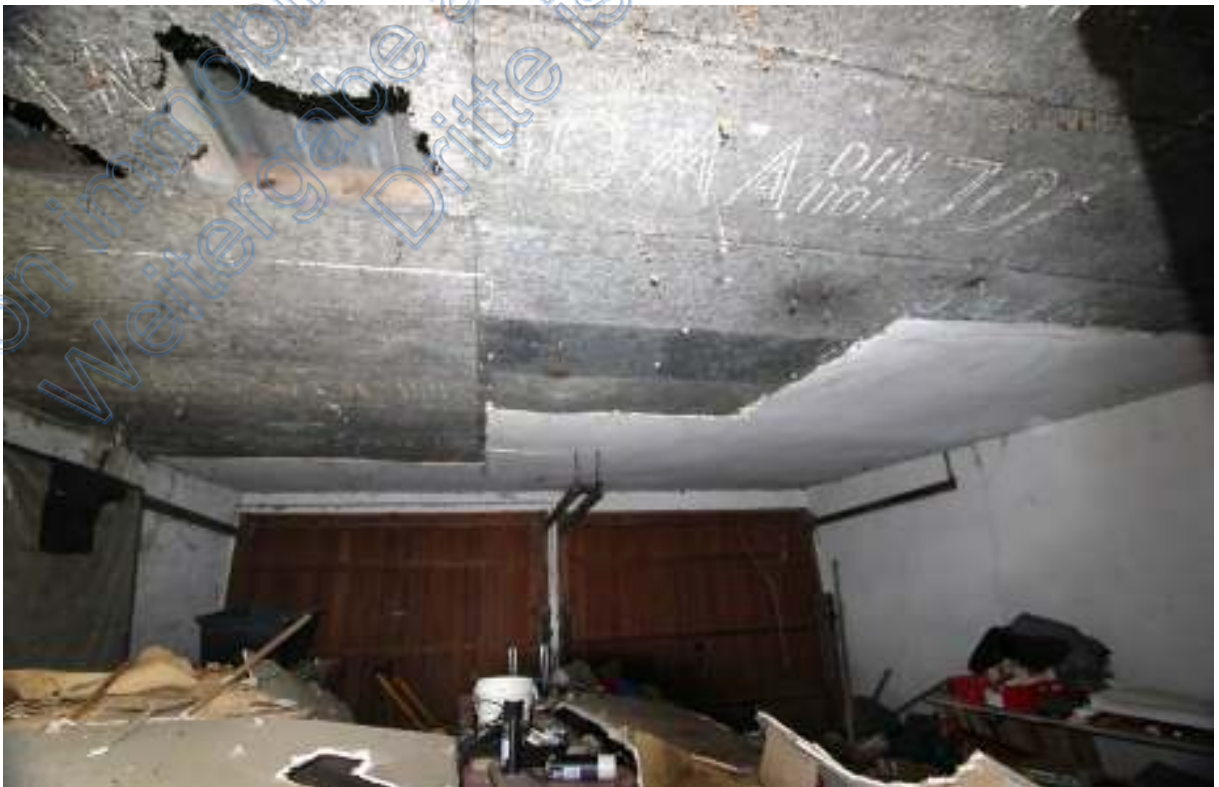
Deckenschäden in der Doppelgarage
