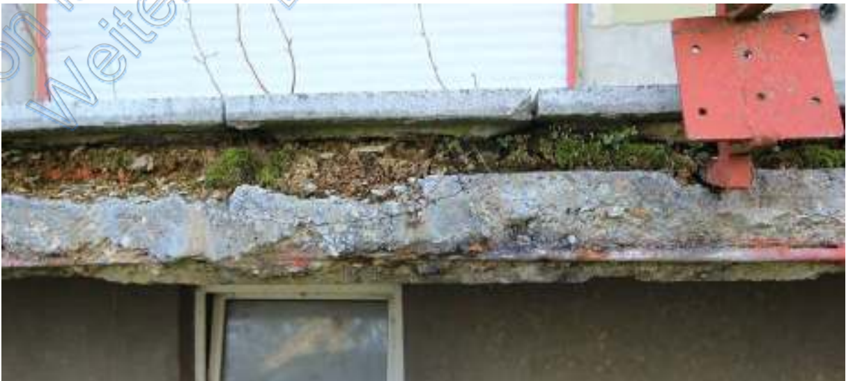
Schäden an der Balkonplatte im EG
