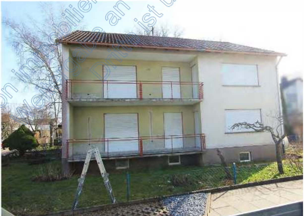
Westseite Zweifamilienhaus mit fehlenden Balkongeländerfüllungen
