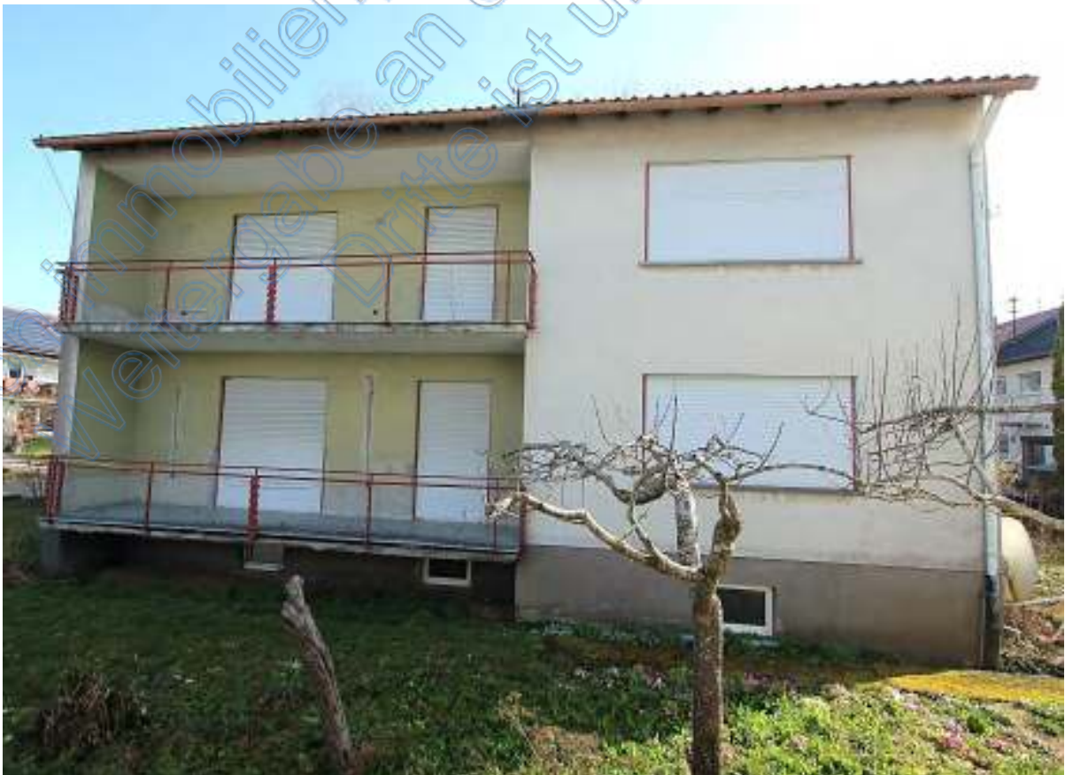
Westseite Wohnhaus mit fehlenden Geländerfüllungen
