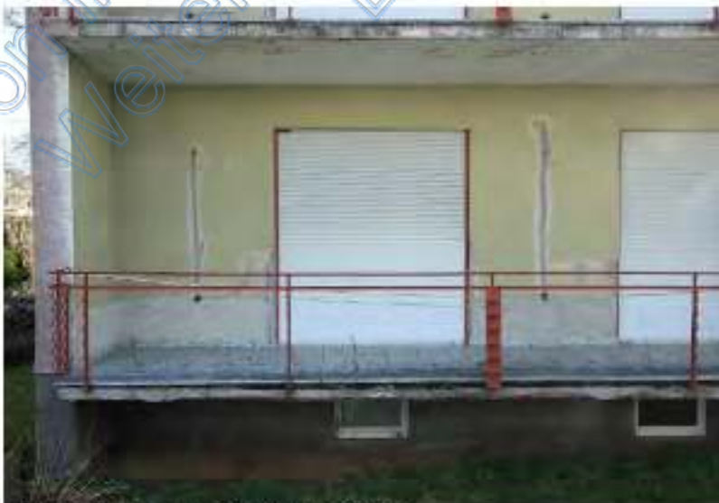
Balkon im EG ohne Geländerfüllung
