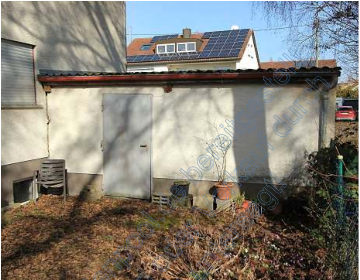
Südseite Doppelgarage mit rostiger Stahltür
