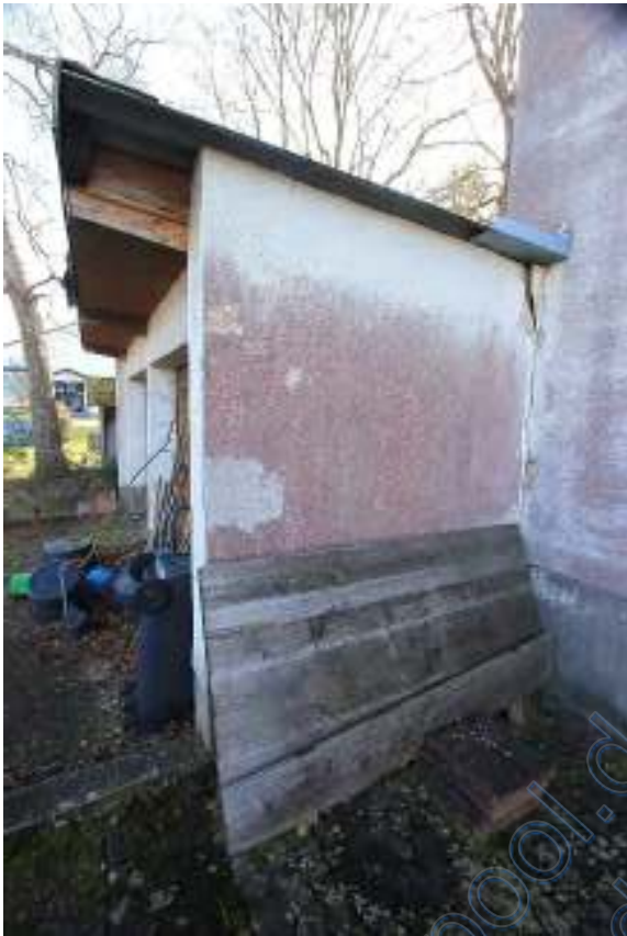
Putzschäden an der Garagenwand
