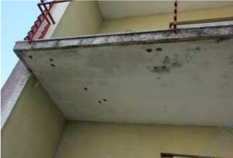
Schäden an der Balkonplatte im OG
