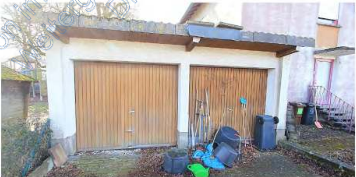
Doppelgarage mit Dachschäden
