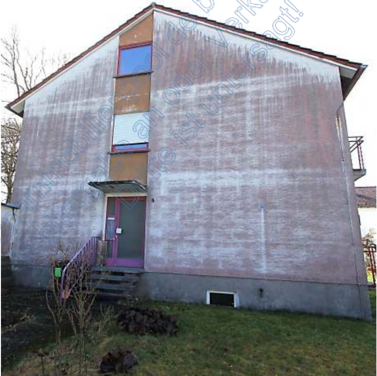
Nordgiebelseite Wohnhaus Hauseingang, Fassadenputz mit Rotalgenbefall
