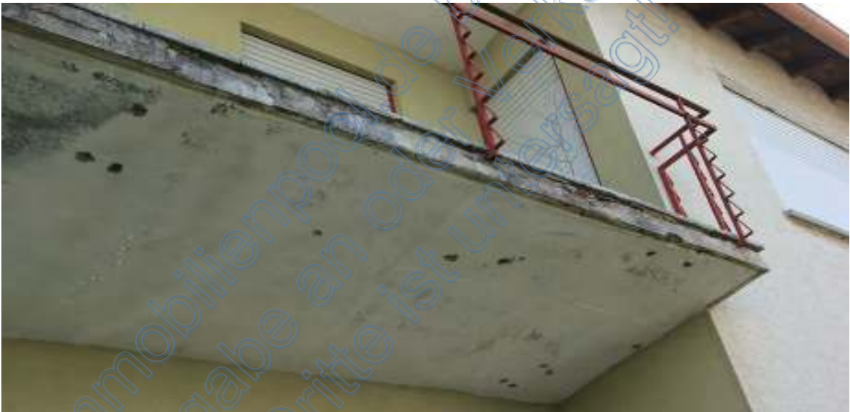
Schäden an der Balkonplatte im OG
