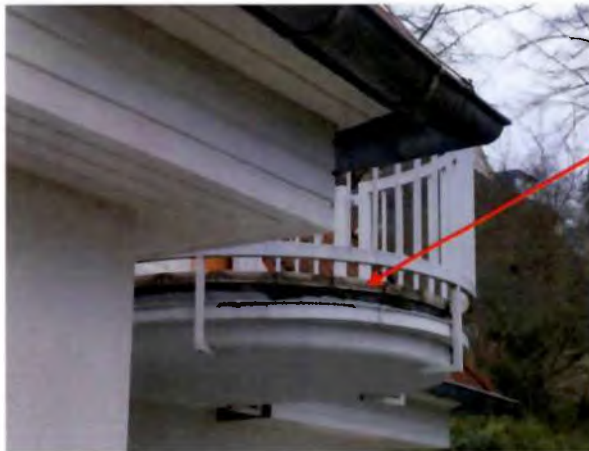
Schäden an den weiteren Balkonen des Gebäudes
