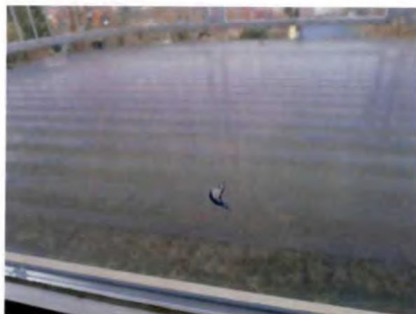
defekte Scheibe Wohnzimmer
