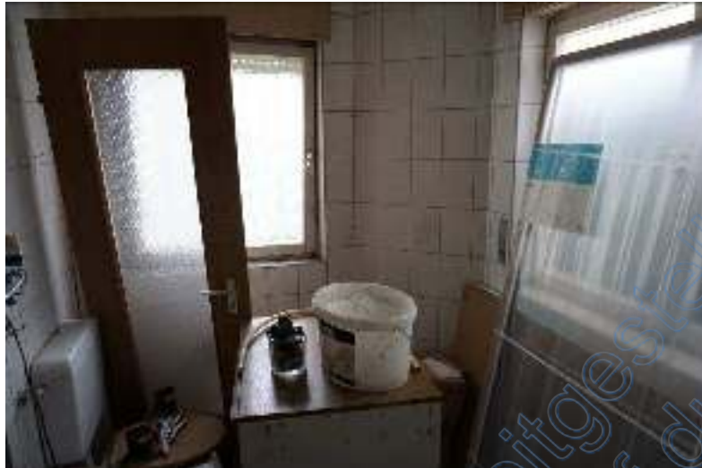
Foto 19: Wohnhaus östlich, EG: ehemals Bad
