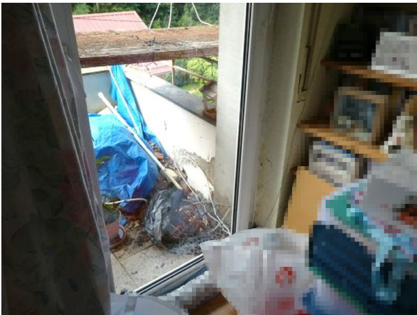
Blick vom Wohnzimmer zum Balkon, Putzschäden erkennbar
