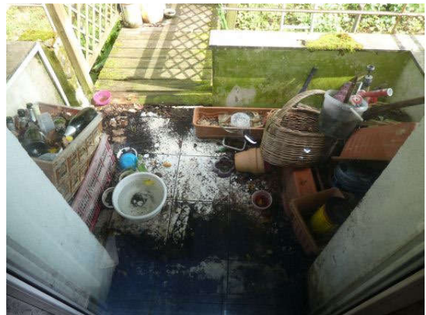
rückwärtiger Balkon, stark verschmutzt
