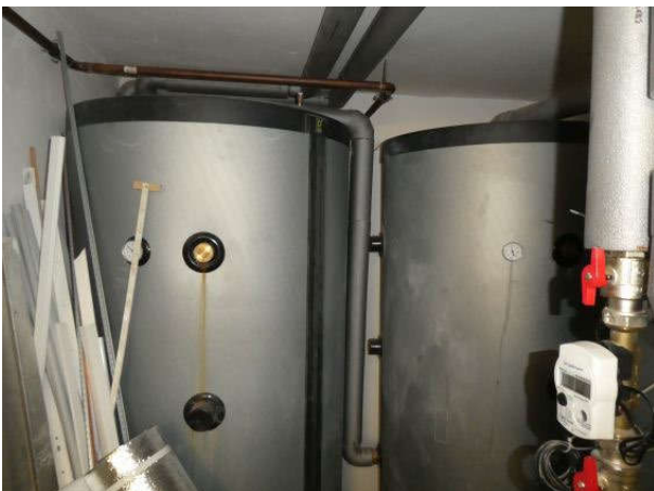
Insgesamt drei Warmwasserspeicher der Solarthermieanlage
