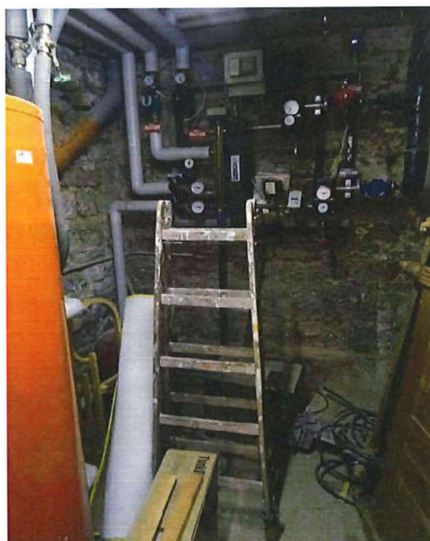
Foto 4: Hausinstallationsraum im KG
