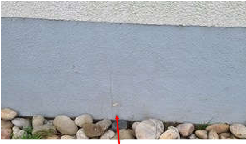
Beispiel für Putzschäden im Sockelbereich (roter Pfeil)
