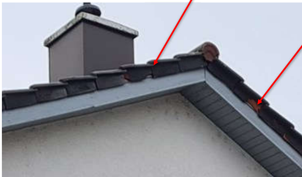
Beispiel für beschädigte Ortgangziegel
