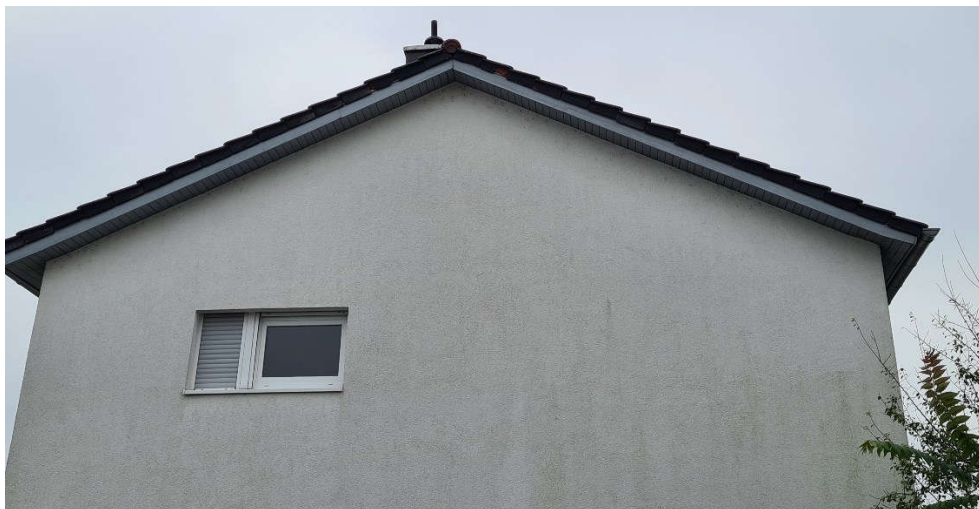
Bemoosung / Bewuchs der Fassade
