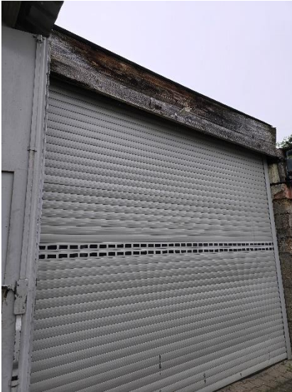
Verwitterte Holzverblendung über dem Rolltor
