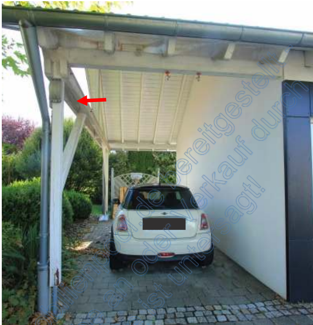
Carport, Pfeil verschmutzter Holzanstrich
