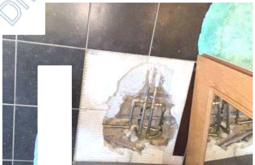
Abb. 5: Foto des SV; z.T. Bodenbelag/Fliesen schadhaft (OG)
