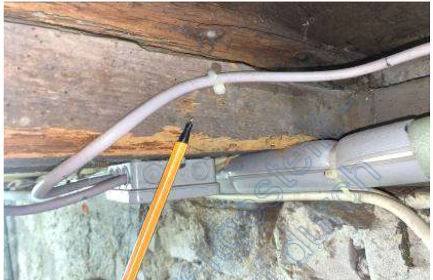
Abb. 3: Foto des SV; z.T. Holzbalkendecke mit Schädlingsbefall (KG)
