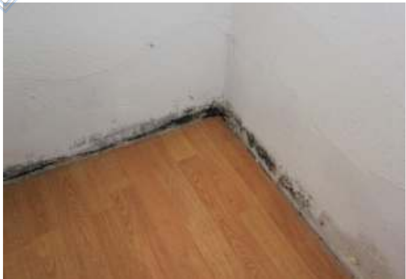
Schimmelflecken an der Wand
