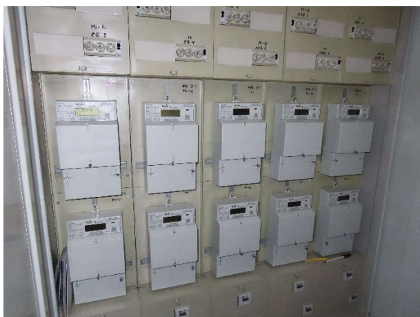
Elektro-Zähleranlage im Kellergeschoss
