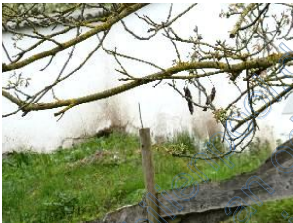
Beispiel für äußere Schadstellen an der Einfriedungsmauer
