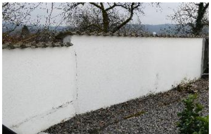
Beispiel für Mauerschäden
