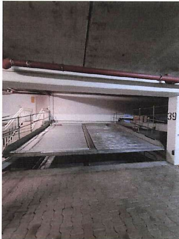
Aufnahme 8: Vierfachparker Tiefgarage
