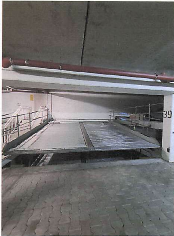
Aufnahme 15: Vierfachparker Tiefgarage
