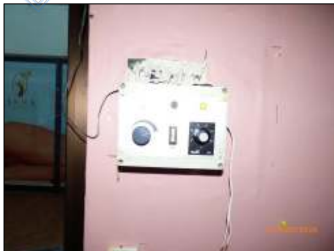
Ansicht: Technik Klimaanlage (Bild 15)
