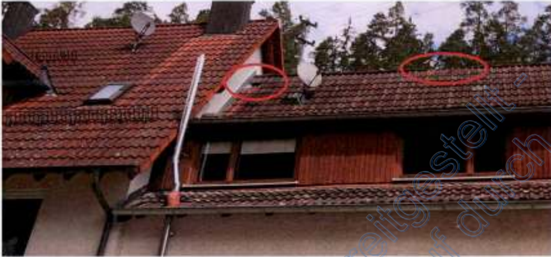
Fehlende Ziegel und Firstziegel
