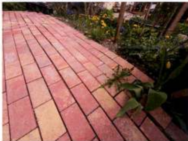
Abgängige Steine auf der Terrasse
