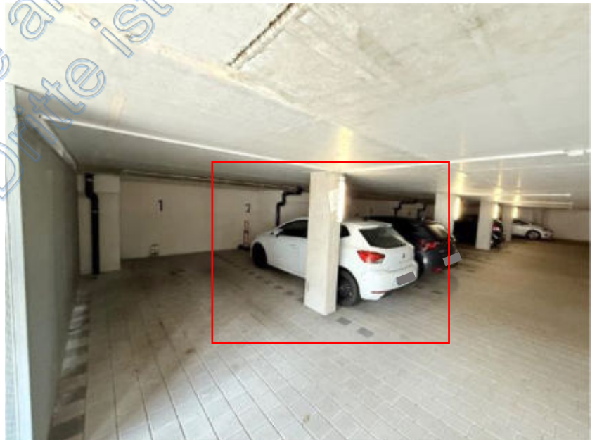
Foto 10 des SV: Tiefgarage; Detail Stellplatz Nr. 2; Rotmarkierung d.d. SV
