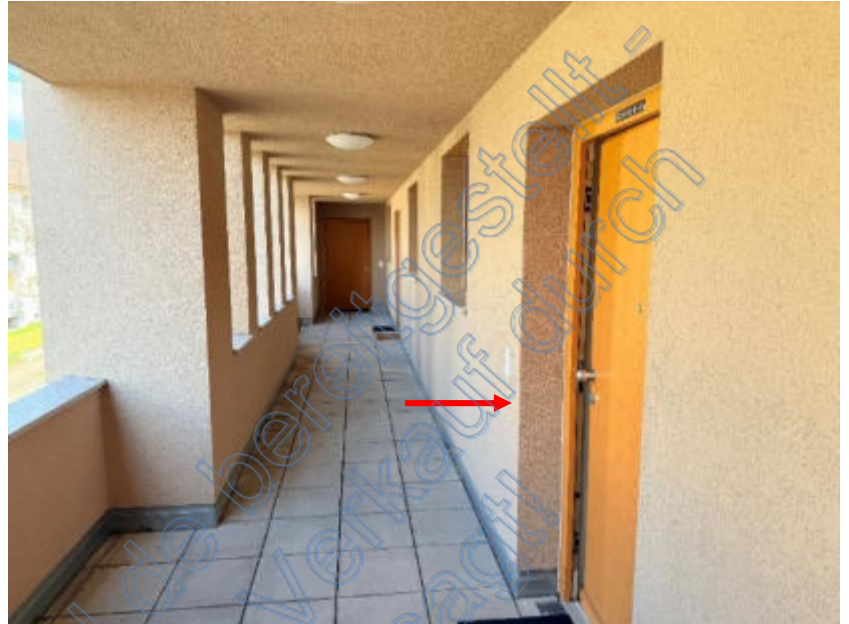
Foto 5 des SV: Goethestraße 37 (Haus 1), 1. OG; Laubengang und Eingang Wohnung Nr. 01.06; Rotmarkierung d.d .SV
