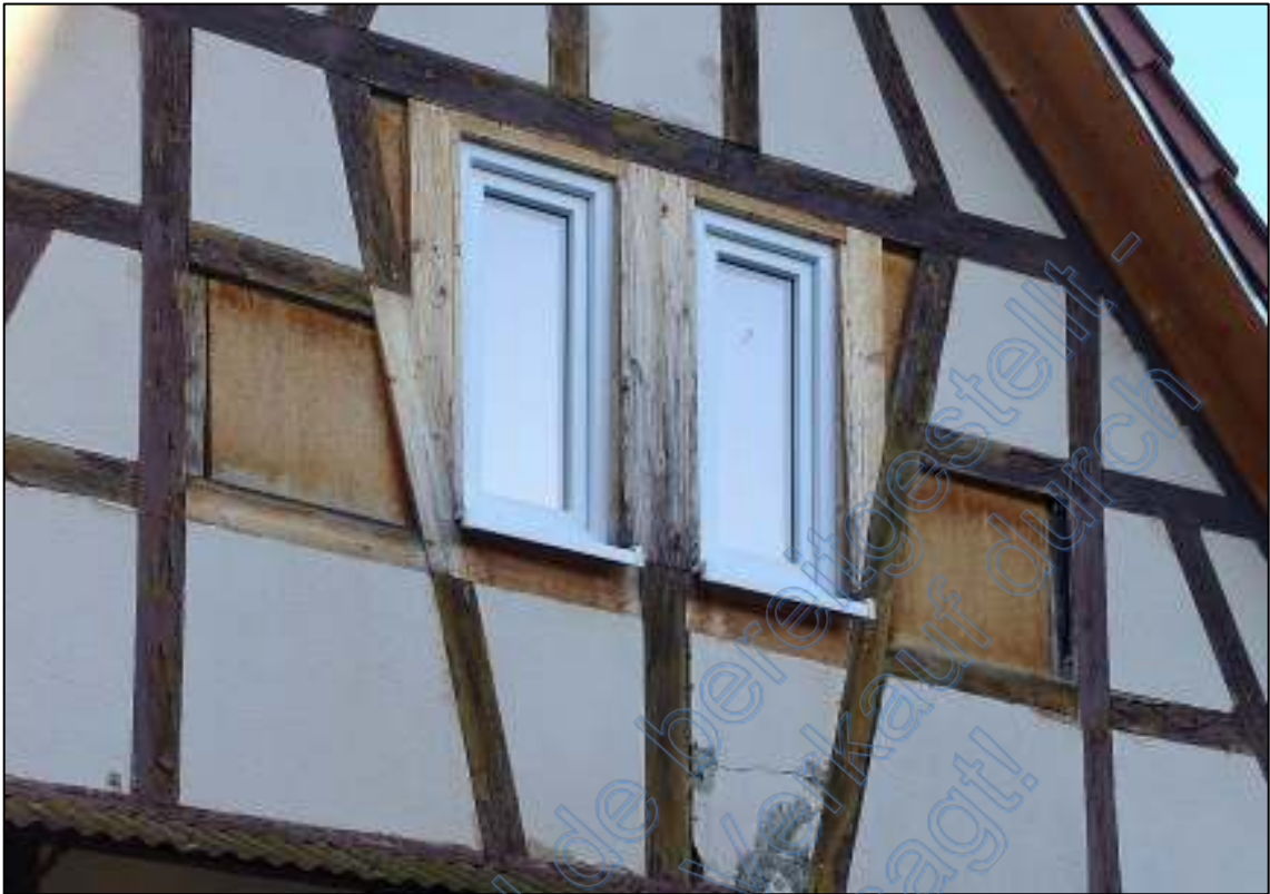
Bild 11 – Fehlende Fertigstellung am Giebel
