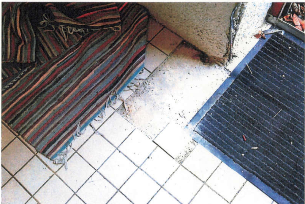
Im Eingangsbereich des Treppenhauses fehlen einige Fußbodenfliesen.
