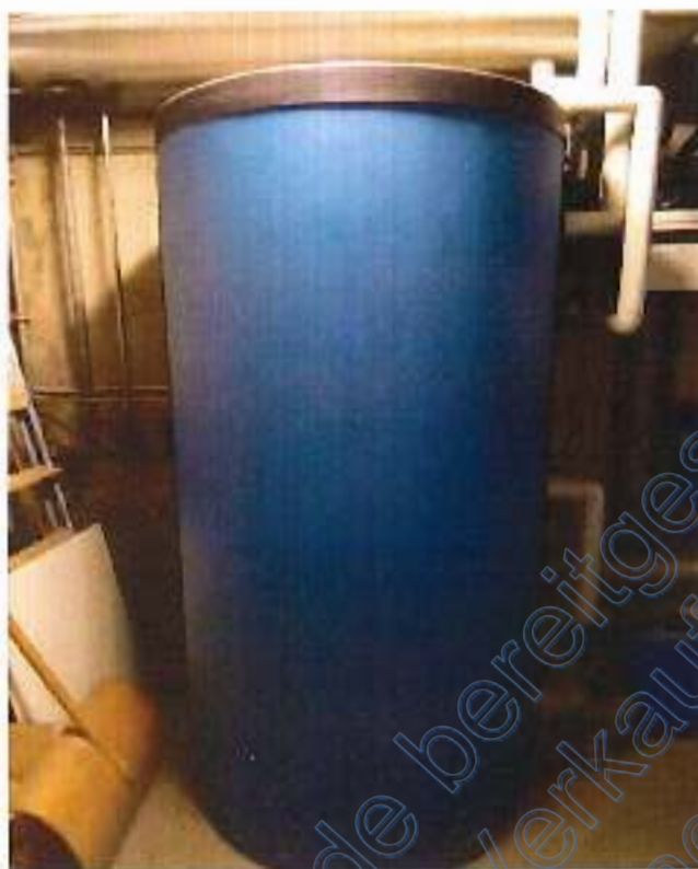
Foto 9: Bivalenter Warmwasser- speicher im KG
