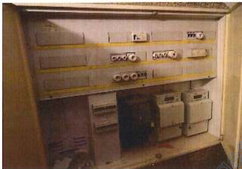
Foto 13: Stromzähler- und Sicherungen im KG-Treppenhaus
