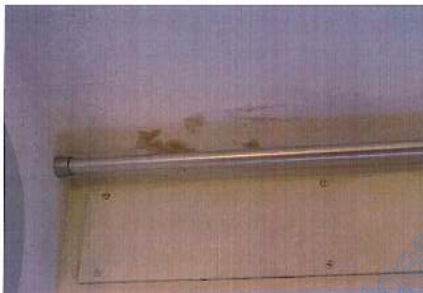
Foto 25: Feuchtelecken an einer Gaube (Dach) in der DG-Wohnung
