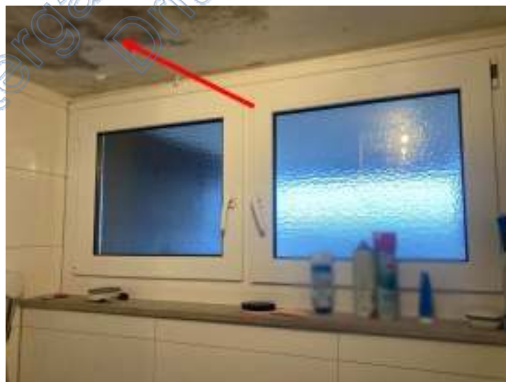
Foto 12: 7. OG, MEA-Nr. 72, 4-Zimmer-Wohnung: Schimmelpilzbefall an der Decke des Duschbereichs mit Farbablösung
