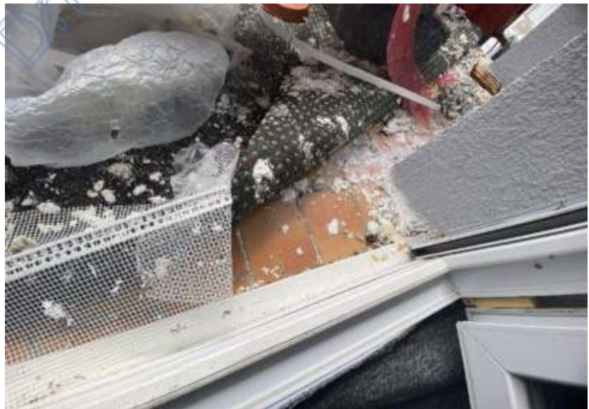
Abb. 6: Foto des SV; z.T. unsachgemäße Bauteilanschlüsse
