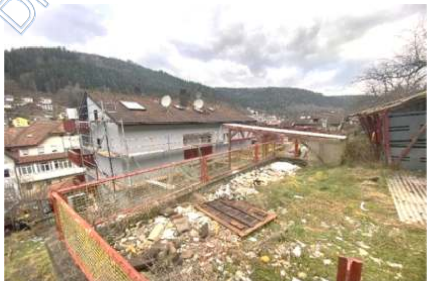
Abb. 12: Foto des SV; z.T. Bauschuttalagerungen auf den Außenanlagen
