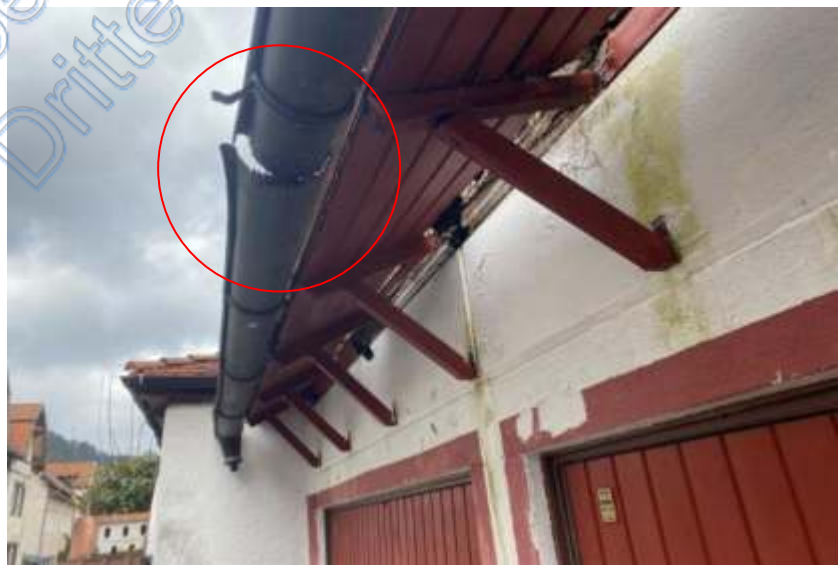
Abb. 3: Foto des SV; schadhafte Überdachung
