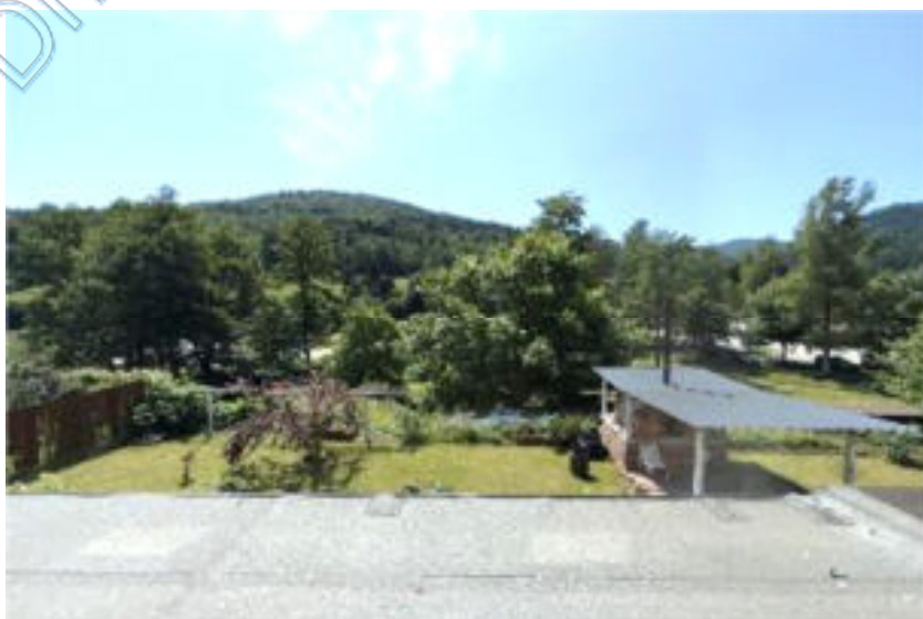
Abb. 9: Foto des SV; Balkon ohne Belag u. Absturzsicherung (EG)
