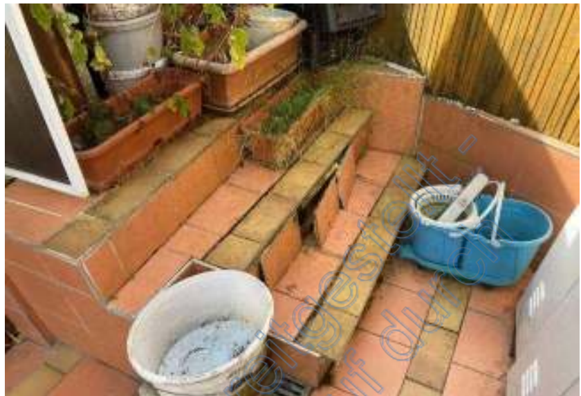
Abb. 3: Foto des SV; z.T. Fliesen schadhaft (Außentreppe)
