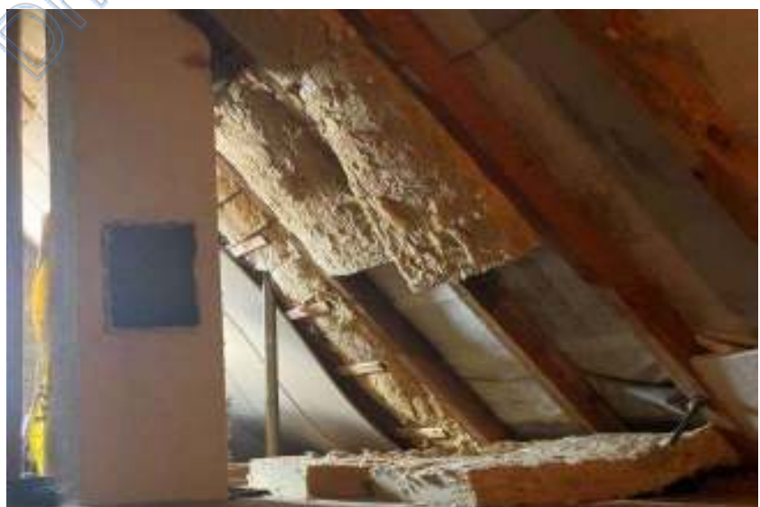
Abb. 5: Foto des SV; z.T. Dachdämmung schadhaft (Spitzboden)
