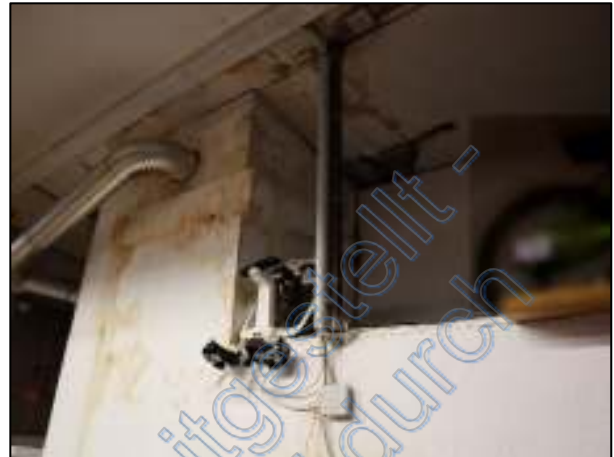
Feuchtigkeitsschaden linke Gewerbehalle EG
