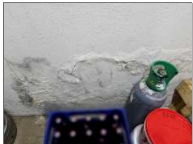
Feuchtigkeitsschaden rechte Gewerbehalle UG
