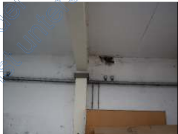
Feuchtigkeitsschaden rechte Gewerbehalle
