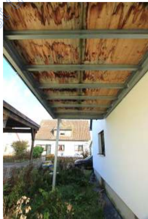
Feuchtflecken an der Balkonuntersicht
