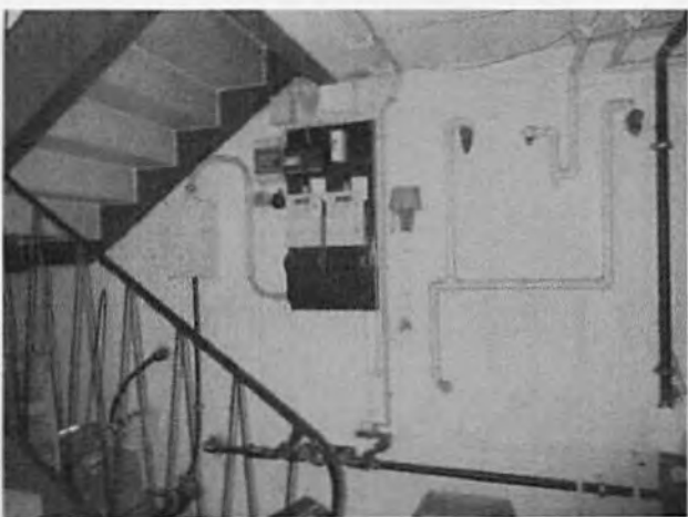
Haustechnik im Treppenhaus
