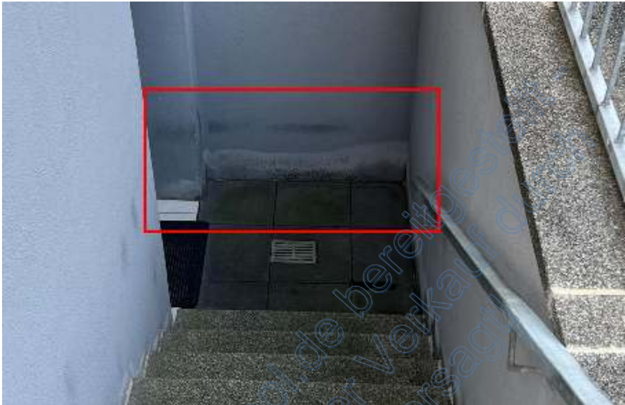
Abbildung 12: Kellereingang mit Verfärbungen im Putz
