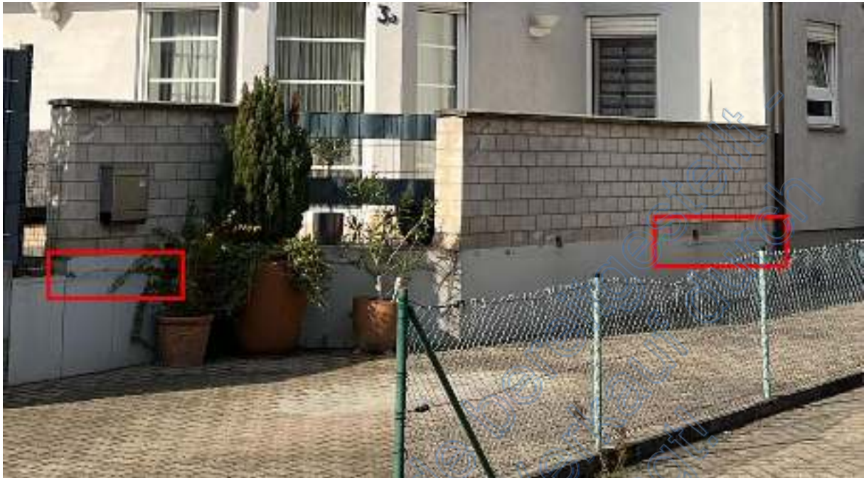
Abbildung 11: Sockelleiste zur Terrasse mit Rissen im Putz
