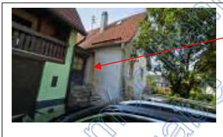
a) Putzschäden / Feuchtigkeitsschaden Eingangsbereich
